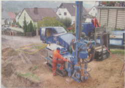
Beliebt auf Meeresgrundstücken, am Berg oder in engen Durchgängen kann das schmale Bohrergerät zum Einsatz kommen. Hier arbeiten die Mitarbeiter der Thüringer Sprengengesellschaft Dirk Ehrhmann (links) und Karsten Zink eines neuen Bauwerts am Kaulsdorfer Dammenberg vor.
